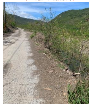
未設置防護護欄
